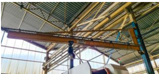
Demag 250kg Swing Crane #9
